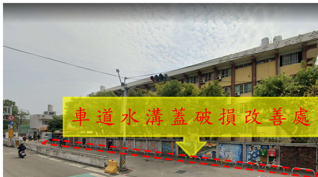
【男生宿舍區外車道水溝蓋破損改善地點示意圖】
