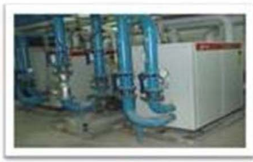
大型冰水主機
