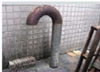
排煙管設在室外
