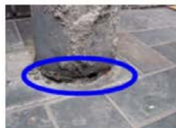
排煙管鏽蝕破洞
