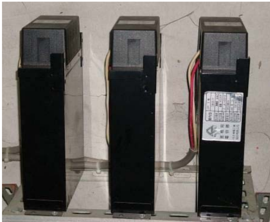
安裝電容器為費用低廉之控制功率因數的手段之一
