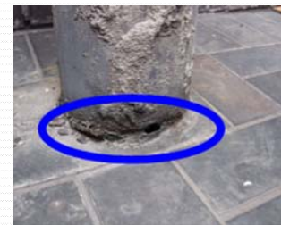
排煙管鏽蝕破洞放大圖
