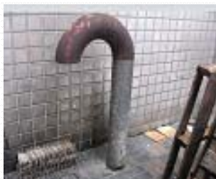
排煙管設在室外
