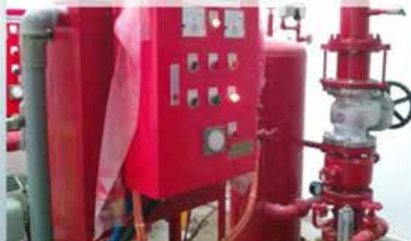
撒水(泡沫)泵浦
