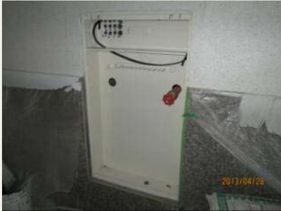
消防栓箱清潔
