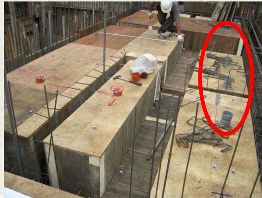
廁所污排水預留套管
