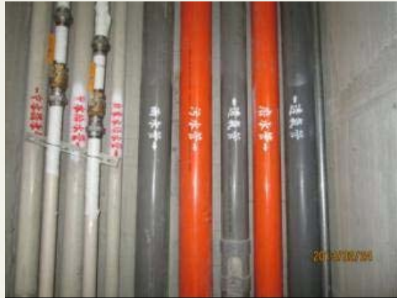
管路流向標示
