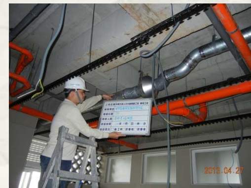
電氣室通風配管
