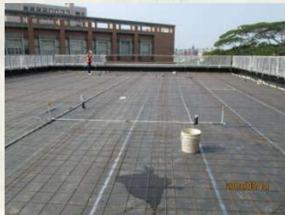
樹海平台配管
