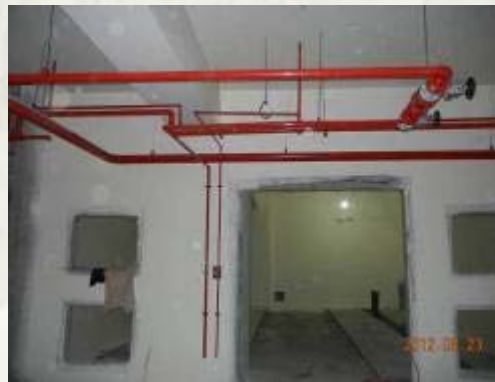
消防泡沫系統配管
