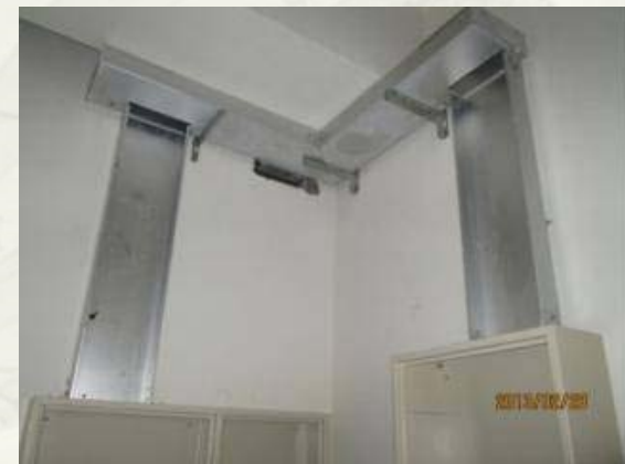
線槽與配電箱連結
