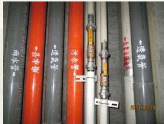
管路功能標示
