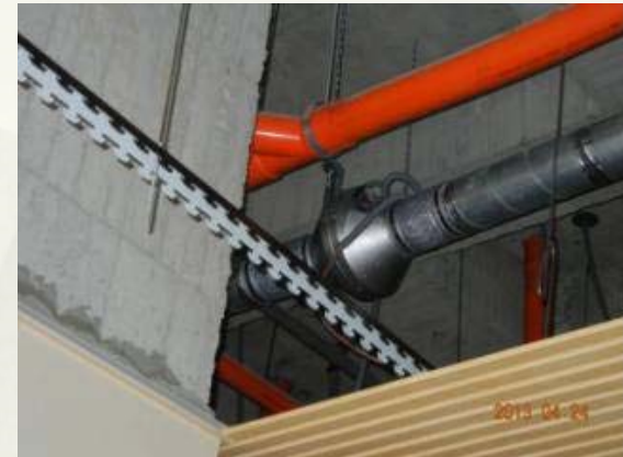
電氣室通風配管
