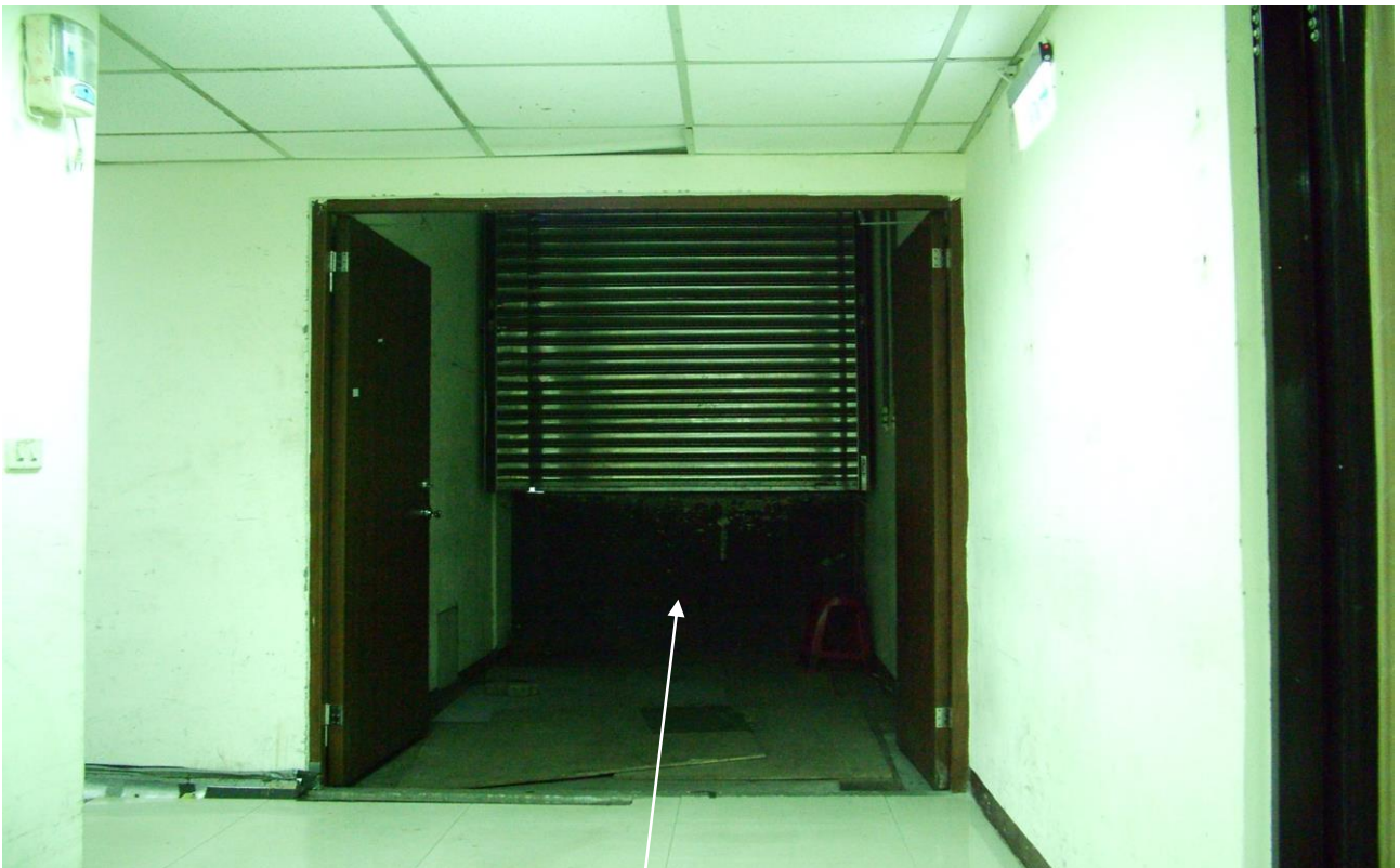
◎ 卸貨口可間接到舞台卸貨,但有橫台,搬卸重物費力。
